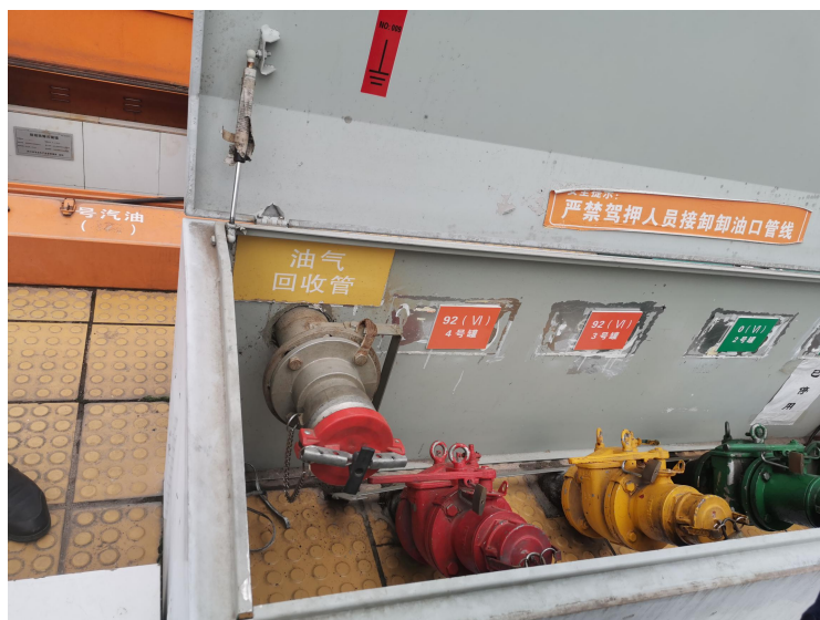
卸油油气回收
