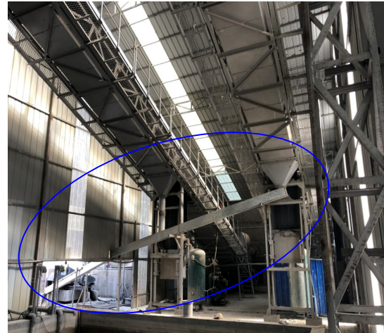
图 5-6 输送带下方废水、渣收集设施
