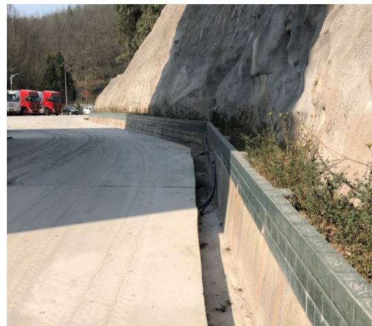
图 5-16 厂区东侧设置的截排水沟、绿化
