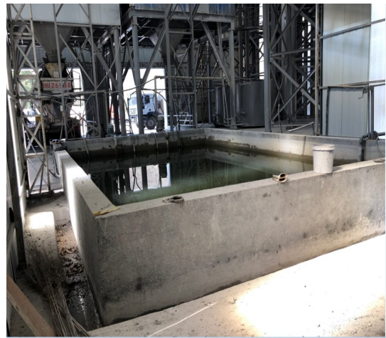
图 5-11 搅拌楼下方已设置的导流沟
