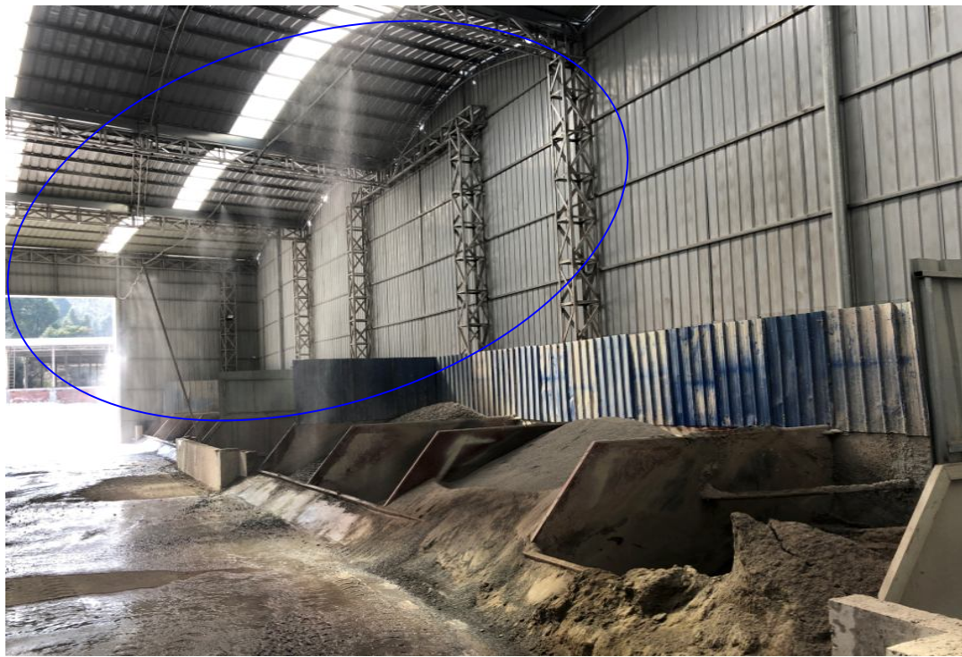
图 5-4 配料斗顶部已设置的喷雾降尘装置
