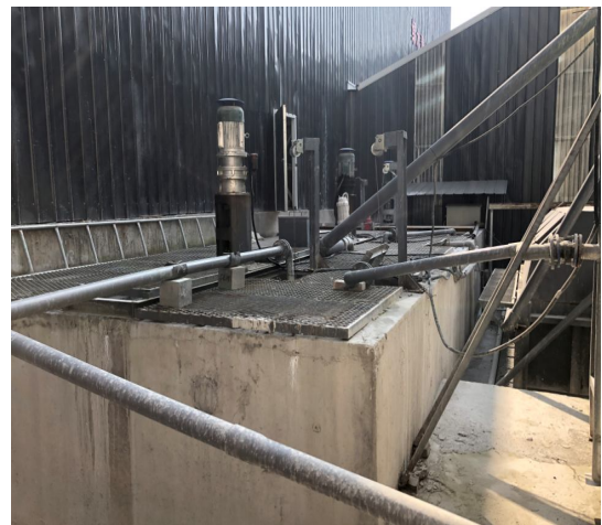
图 5-8 厂区已设置的三级沉淀池
