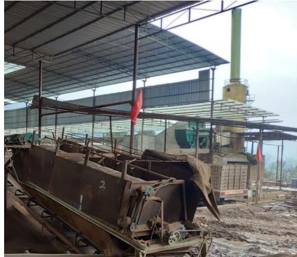
脱硫塔及排气筒
