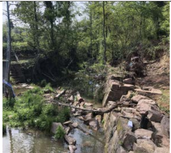
尾水渠挡墙破损、垮塌
