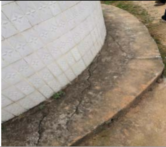
机房基座裂缝
