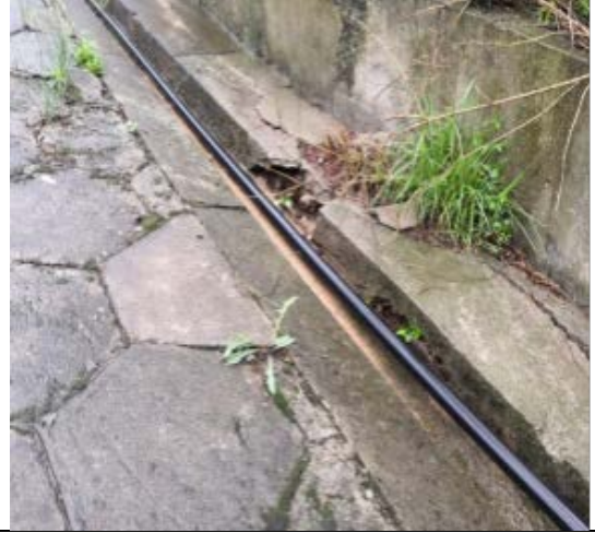
排水沟、挡墙破损
