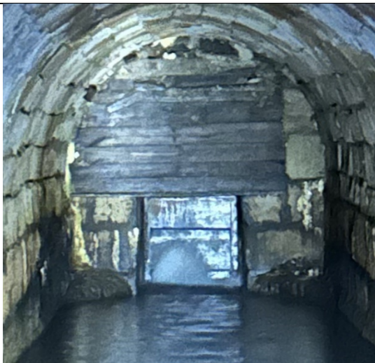
闸门埋件腐蚀
