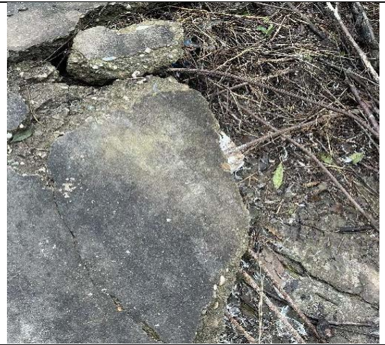
末端底板钢筋外露
