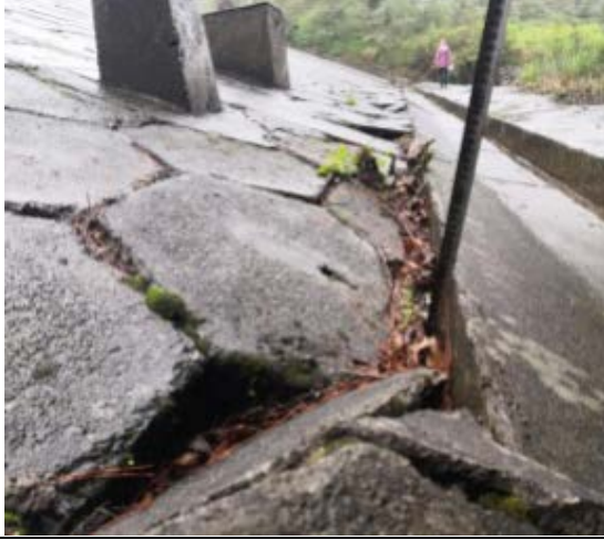
下游护坡破损
