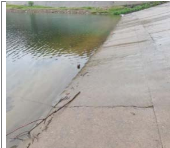
上游护坡破损
