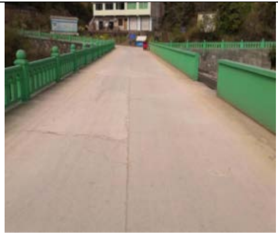
坝顶裂缝、防浪墙不闭合
