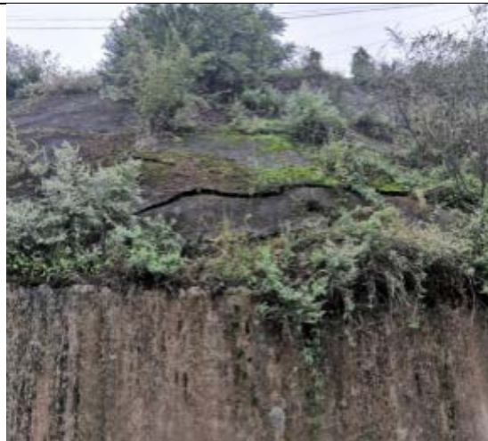
边坡锚喷衬砌开裂、变形
