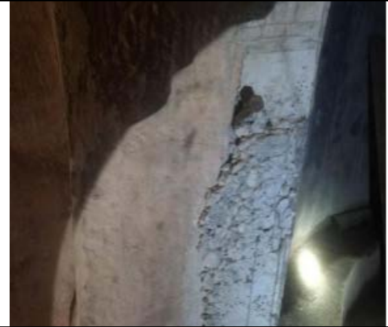
井壁破损、骨料外露
