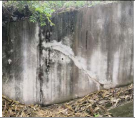
边墙裂缝渗水析钙
